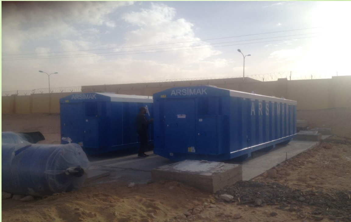
Station d'épuration de la base de vie d'EURL TOUATI (W.OUERGULA)
